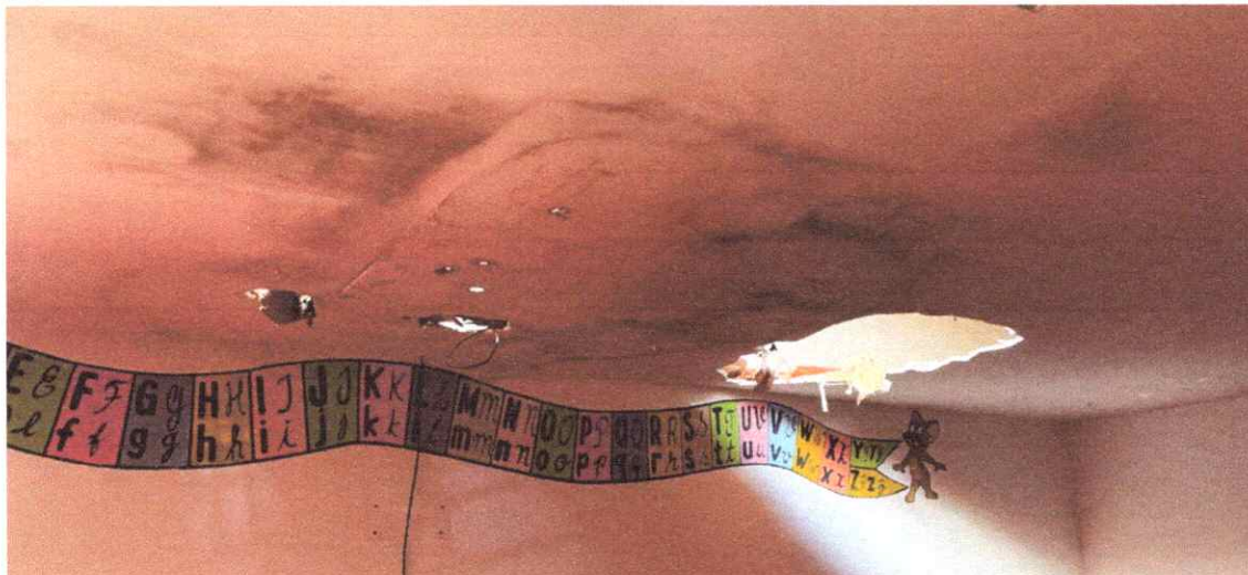
Anexo 04: Forro de gesso deteriorado por ação dos problemas com a coberta. Data: 24/02/2025
